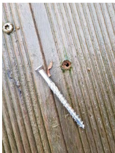
◀ Bild 1: Terrassenbelag auf einer Stahlkonstruktion verbaut
