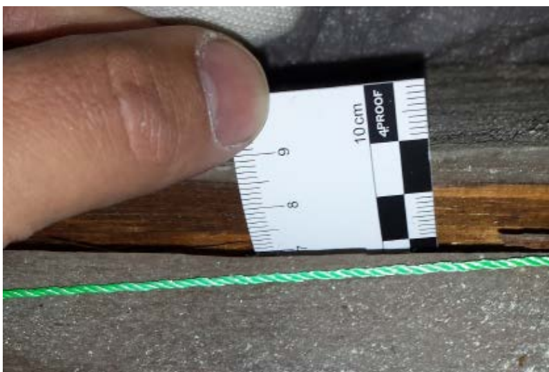
◀ Die Risse in der Mittelpfette waren zum Teil 18 mm breit und bis zu 90 mm tief
