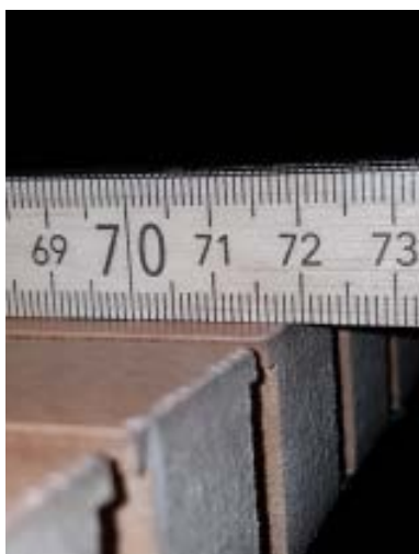
◀ Breite der heruntergefallenen Deckenplatte
